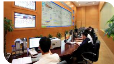
ECC控制中心
